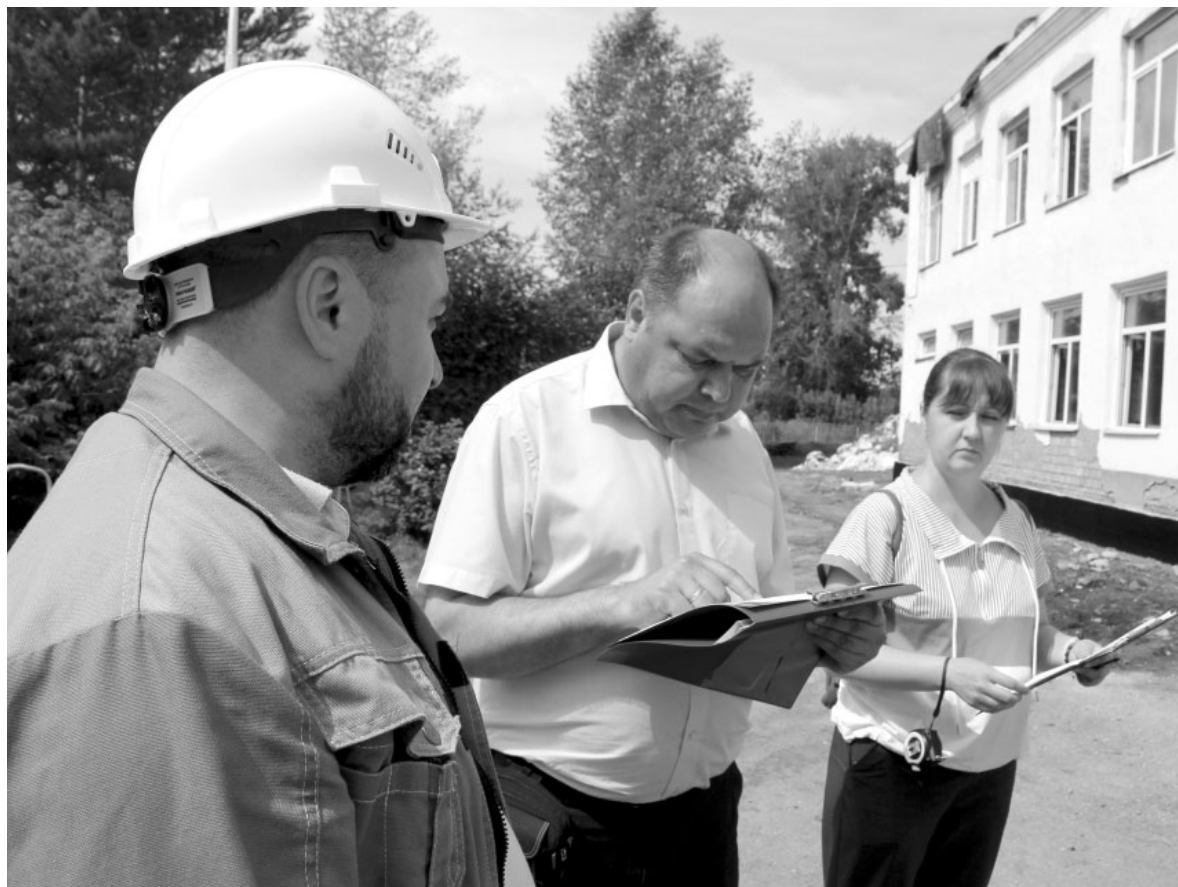
Благодаря финансовой поддержке компании РУСАЛ выполнены ремонтные работы в двух школах района, а в школе п. Горный в течение двух лет планируется провести большую реконструкцию.
